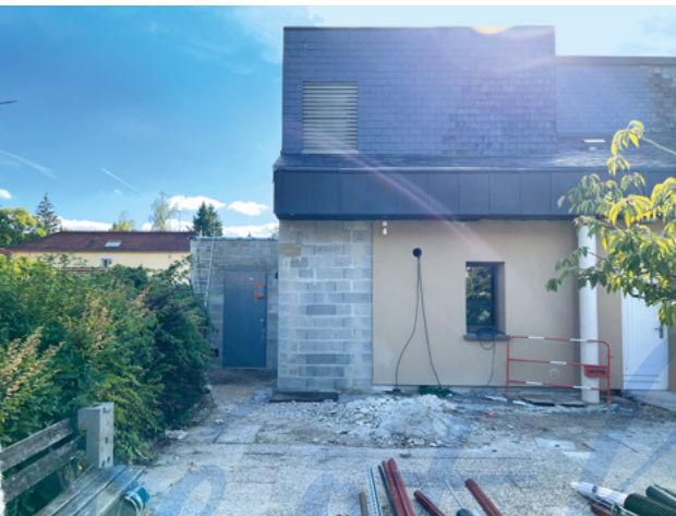
Le local technique qui abrite l'échangeur et la pompe à chaleur.
