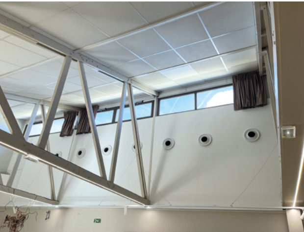
L'intérieur de la salle des fêtes, avec les bouches d'air pulsé.
